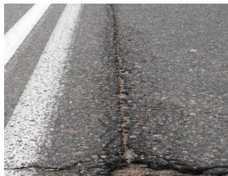
Рис. 3. Разрушение покрытия в зоне технологической трещины
