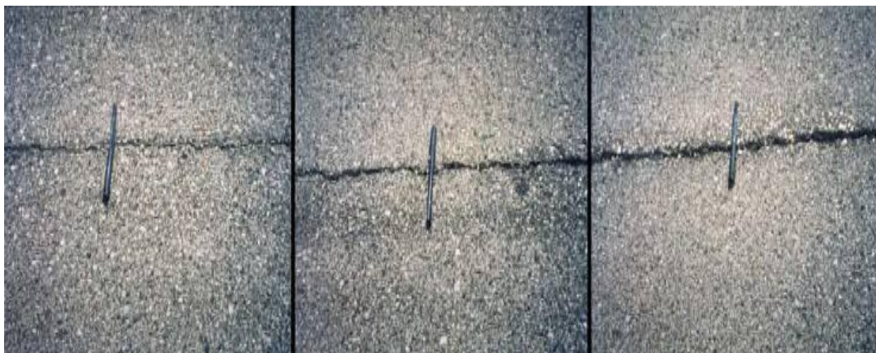
Рис. 1. Динамика разрушения «технологических» трещин покрытия
